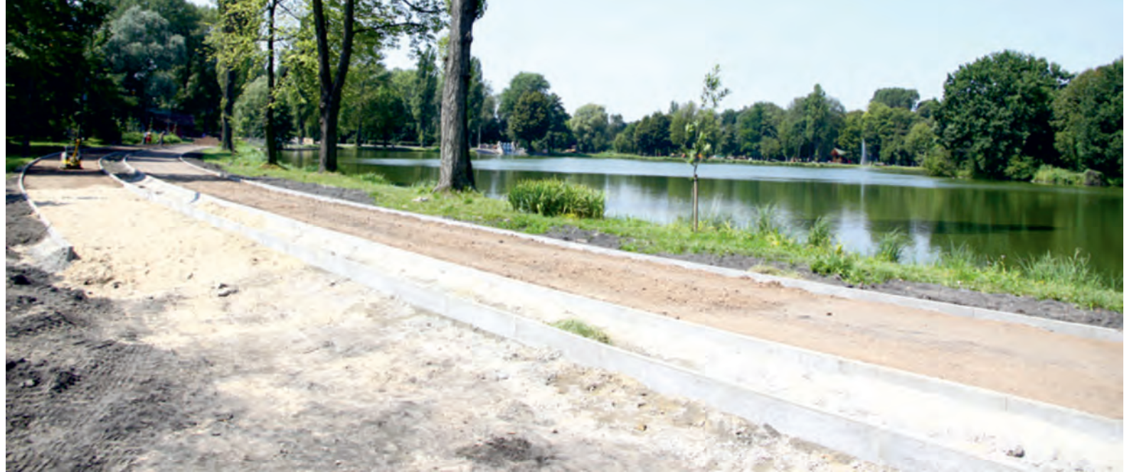
Budowa pieszej i rowerowej ścieżki wokół stawu Cylkego w Parku Miejskim w Zgierzu.
