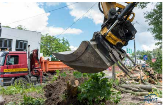
Prace porządkowe na ul. Osiedlowej, gdzie powstaje jedna z Otwartych Stref Aktywności
